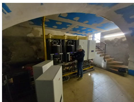
Impianto termico scuola Media
