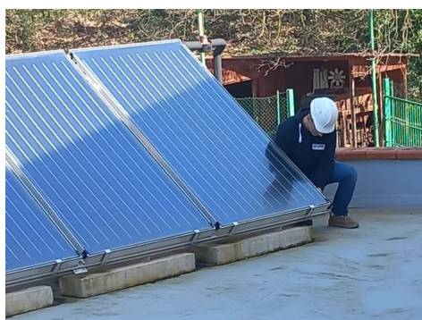
Impianto solare Termico Palazzetto
